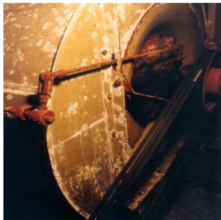
De ventilator na 4 jaar bedrijf in 1992
